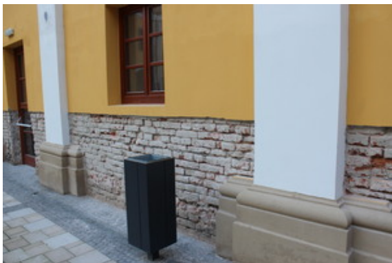
stav zdi při vysychání
